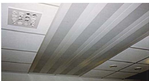
Bilde 1. Viser META SkyCooler fra et anlegg hvor mer enn 1000 stk SkyCooler er installert
